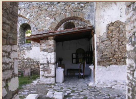
Τό έσωτερικό του ιερού Ναού μετά την καταστροφή του εκ πυρκαϊάς.
